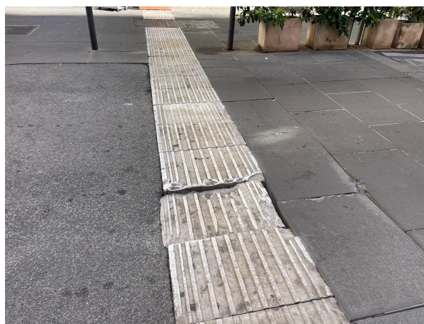
Fig.4 pavimentazione e LOGES non regolari su via Daniele Manin
